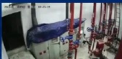
18: 25进入学校负一层水泵房
